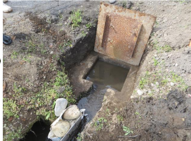
正常に水が流れた
